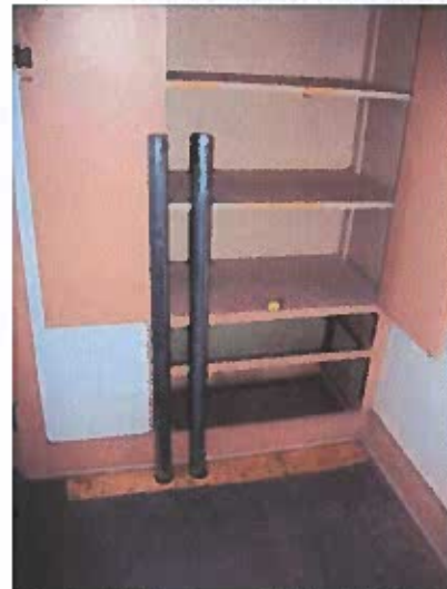
Mech 206 - Panel D feeder conduits
